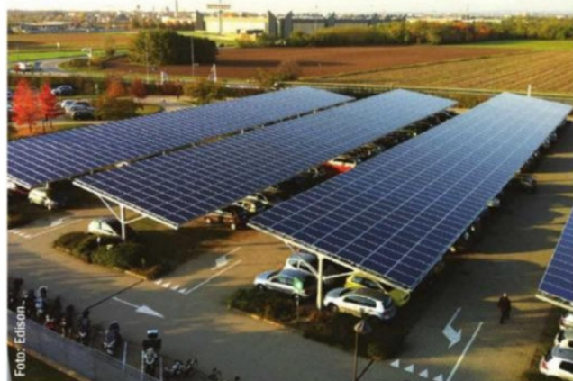
ENERGIA FOTOVOLTAICA - IMPIANTO FABBRICA ROCHE A MONZA
