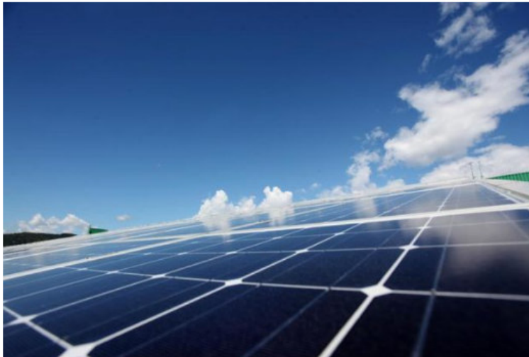
Pannelli solari dell'impianto fotovoltaico da 1,03 MWp della ditta Roncadin, inaugurato a Meduno, Pordenone, 22 luglio 2011. La ditta, specializzata in pizze surgelate, ha sfornato la prima pizza cucinata nei forni industriali alimentati esclusivamente a energia solare. ANSA / STEFANO LANCIA
