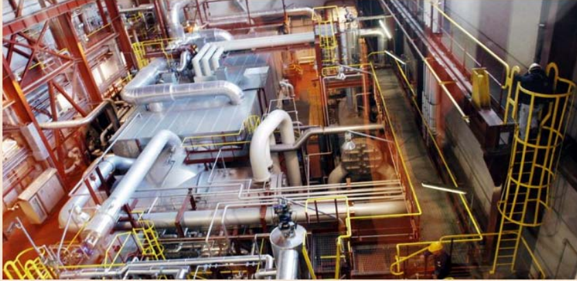
Impianto di termovalorizzazione (Contrasto)
